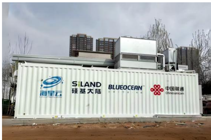
浸没式液冷可移动集装箱式高密度绿色数据中心外观图
